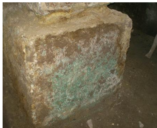
Slika 14. Dejstvo elektrolita na noseći stub na dubini većoj od jednog metra
