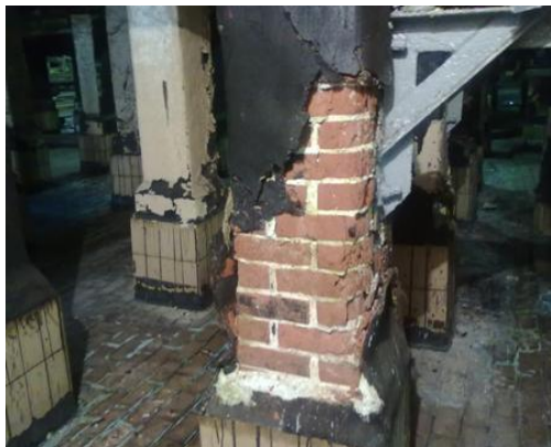
Slika 11. Oštećeni noseći stubovi kada
