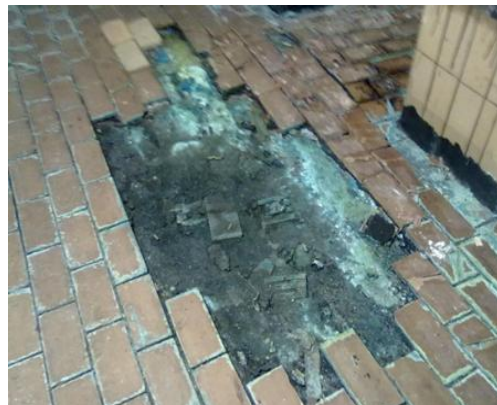
Slika 9. Oštećene pločice i beton
