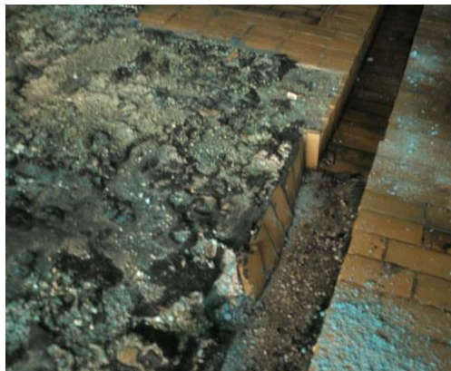
Slika 8. Izgled oštećenog kanala za odvod elektrolita prema zbirnoj jami
