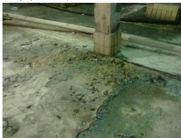
Slika 5. Pucanje betonske ploče pod dejstvom kristalizacije bakar-sulfata
