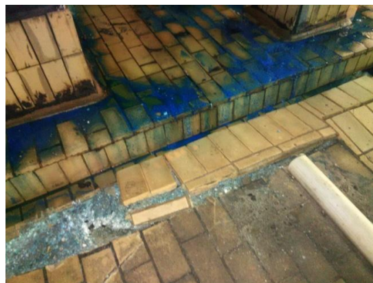
Slika 4. Izgled kanala za odvod elektrolita
