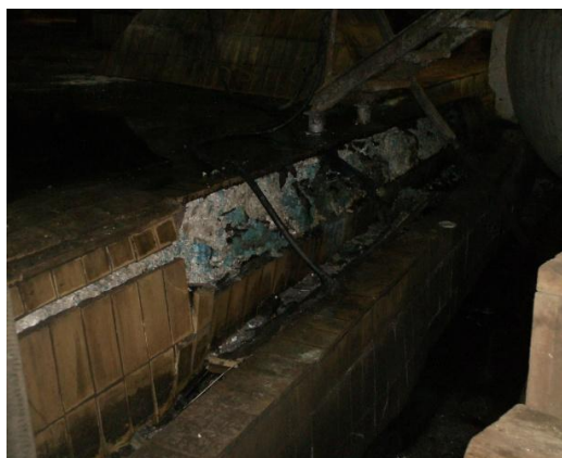
Slika 13. Oštećeni kanal za odvod elektrolita
