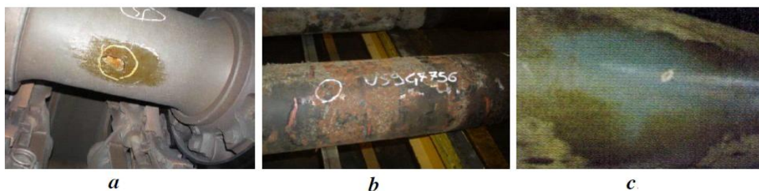
Slika 5. Primeri oštećenja osovina železničkih vozila tokom eksploatacije. a: odvajanje farbe; b: rupičasta (pitting) korozija; c: oštećenje od udara balasta [1]
